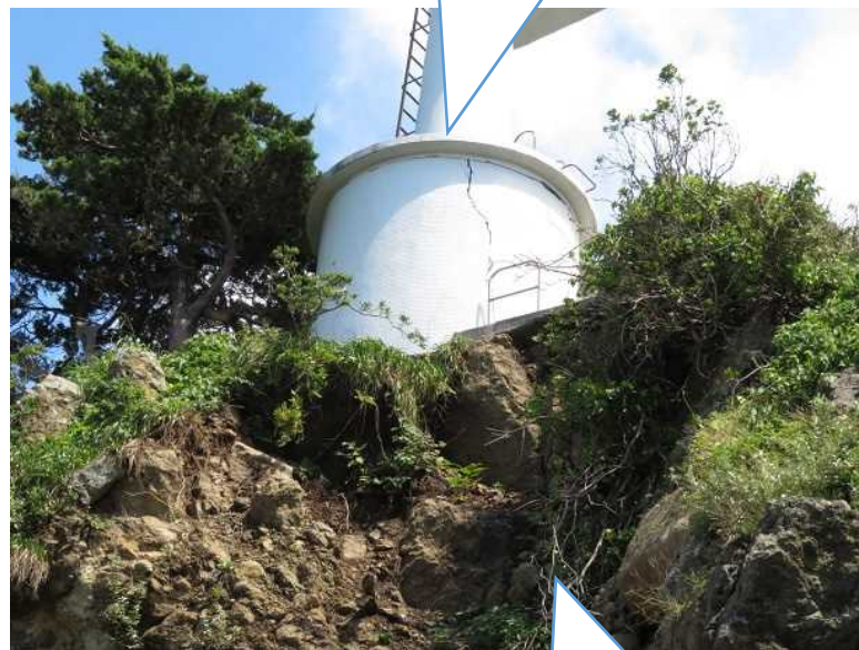
灯台の地盤が崩落
